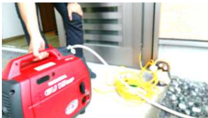
ガス式発電機作動
