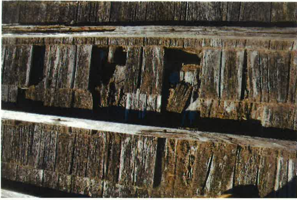
工事前の状況 樽板破損状況
