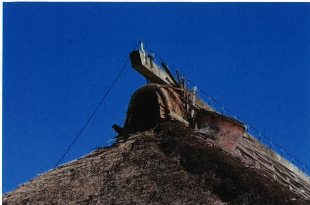
土倉棟部分損壊状況
