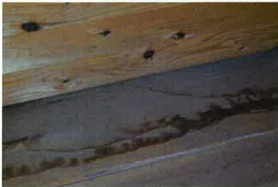
⑪ 南面 台輪上に雨染み
