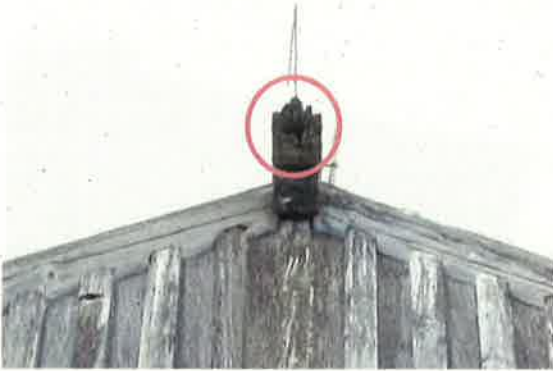
③ 東面 樋棟木口の腐朽
