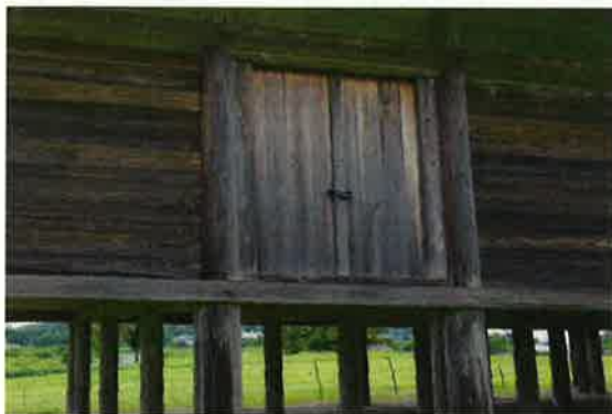
⑮ 扉の湾曲、金具の浮き
