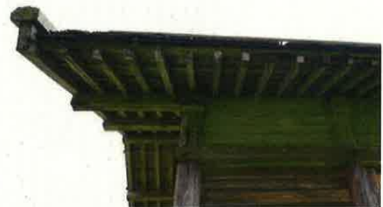
⑭ 東面南_ウダツの腐朽、クレ板の腐朽と欠損
