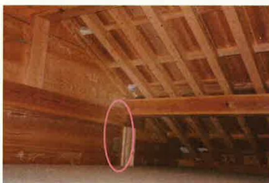
㉓ 板倉南 _ 南妻面, 雨染みあり
