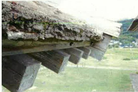
⑧ 東面 _ 軒先 (クレ板木口の腐朽・苔・茸繁殖)
