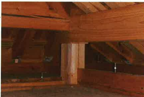
⑬ ボルト使用状況、ナットのゆるみ
