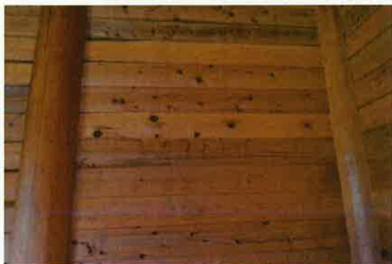
⑪ 南面 _ 雨染み状況
