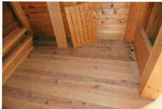
④ 東面_床の雨染み
