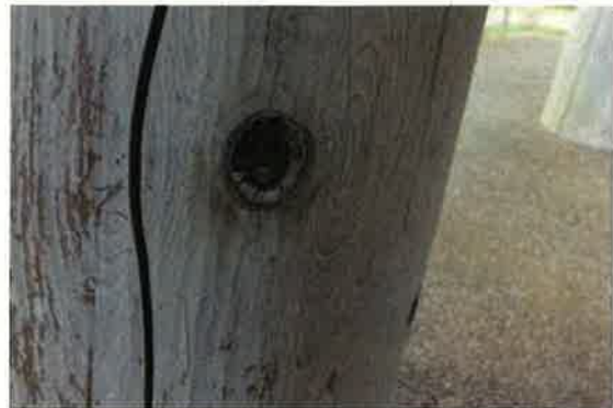
② 節の腐朽落脱
