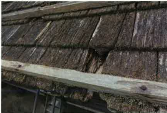
③ 東面 _ クレ板の腐朽・欠損・苔繁殖
