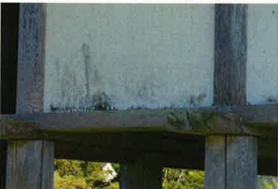
⑬ 北面東 漆喰壁に黒カビ汚れ
