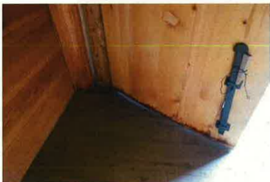
⑮ 扉・側壁板・側柱下部の雨染み、金具外れ
