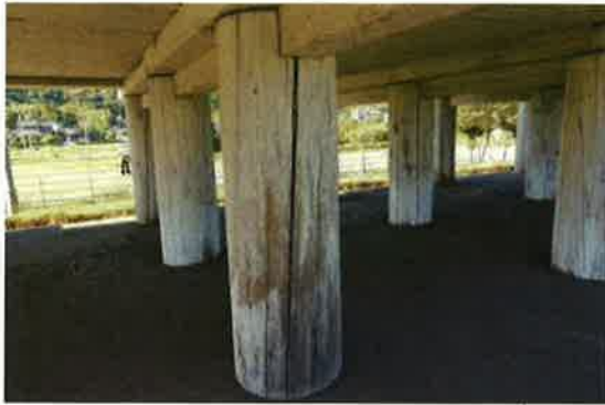
① 束柱割れ
