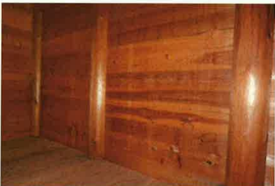
⑤ 北面_雨染み(節からの雨染み多い)
