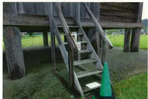
⑯ 階段の腐朽、タタキの苔
