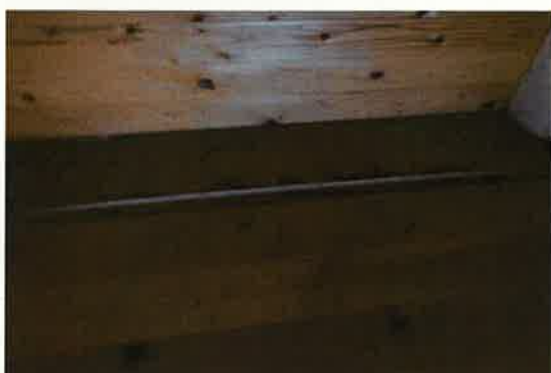
④ 南面 台輪上に雨染み
