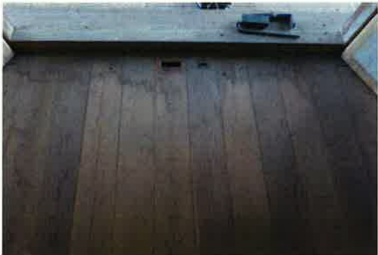
⑬ 東面 出入口床に雨染み
