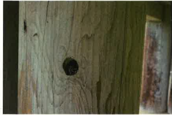
② 節の腐朽
