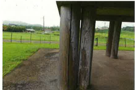
④ 柱の割れ
