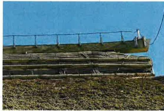
⑩ 北面西 棟 ひしぎ竹欠落
