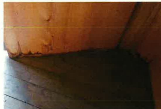
⑯ 扉・側壁板・側柱下部の雨染み、床の雨染み
