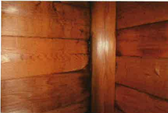
③ 北東角_腐朽状況(黒変と白カビ)
