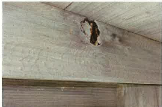
④ 節の腐朽落脱
