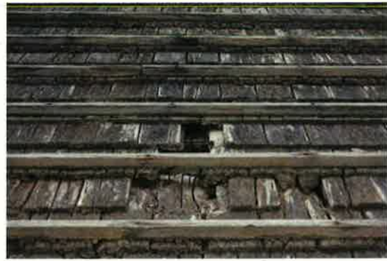
② 東面 _ クレ板、板押えの腐朽・欠損
