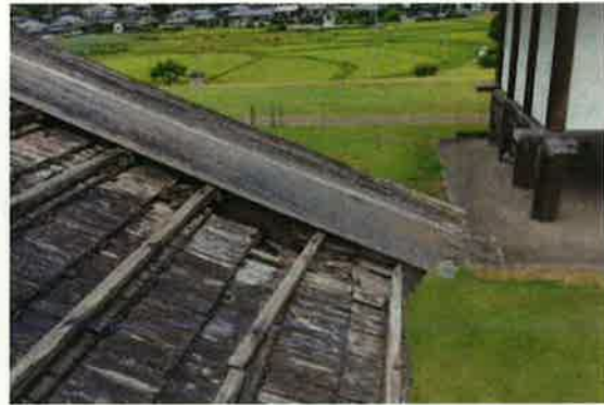
④ 東面北端部 _ クレ板の腐朽・欠損
