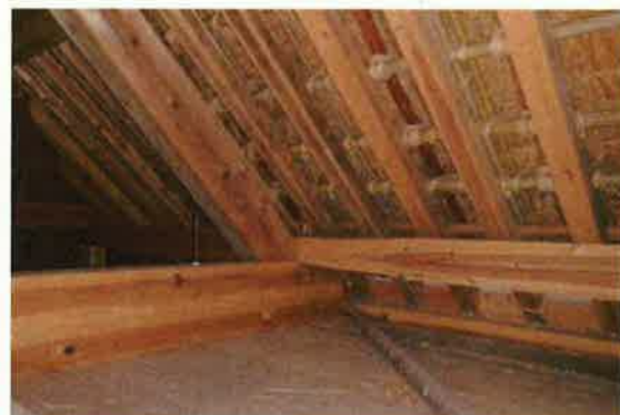
㉔ 小屋組の納まりとボルト使用状況 鳥の糞あり
