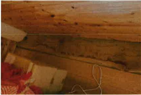
⑨ 南面 台輪上に雨染み
