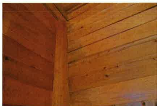
⑬ 東面 _ 黒い薄染み汚れ
