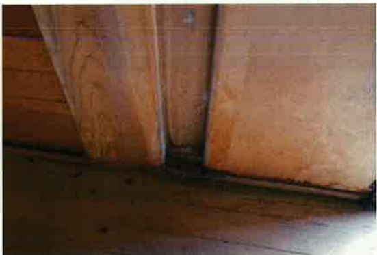
⑤ 南面東扉下部、側壁板、台輪上、床に雨染み
