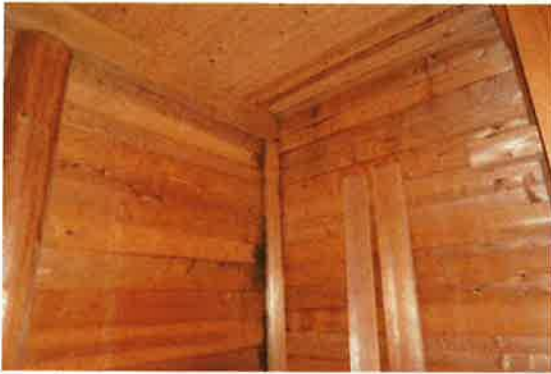
① 北東角_腐朽状況
