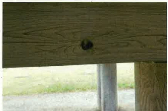
⑥ 大引_節の腐朽
