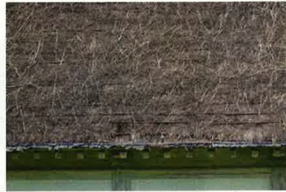
④ 南面中央 茅の欠損とオシボコ・杉皮の露出
