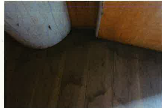
⑭ 東面 出入口床に雨染み、板壁に雨染み
