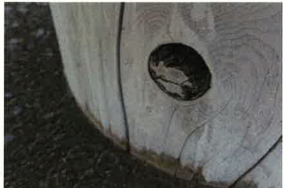
④ 節の腐朽落脱
