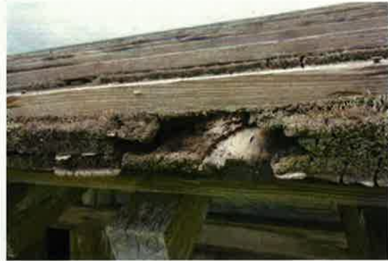
⑥ 東面 _ 軒先 (クレ板木口の腐朽・苔・茸繁殖)
