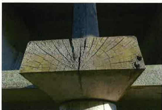
⑦ 北面_台輪の割れ、苔、虫害
