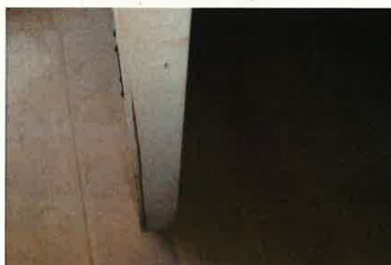
⑧ 東面 扉の亀裂
