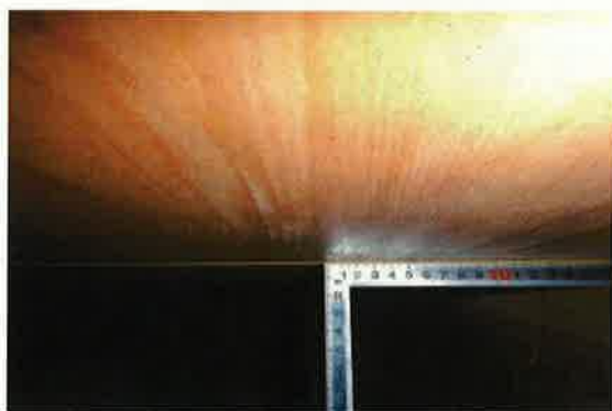
⑦ 東面 扉の反り
