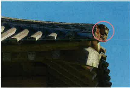
⑨ 北面 隅樋棟の木口の腐朽欠損
