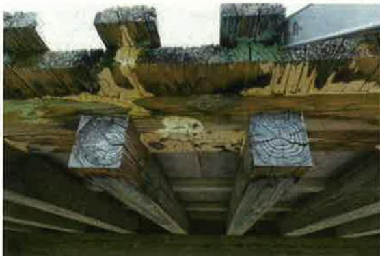
⑦ 南面 目板と葺板の木口付近の地衣・苔
