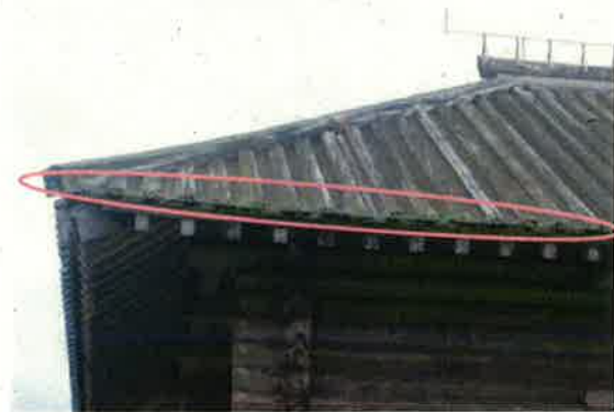
⑫ 南面 屋根目板と葺板の木口の腐蝕と苔繁殖
