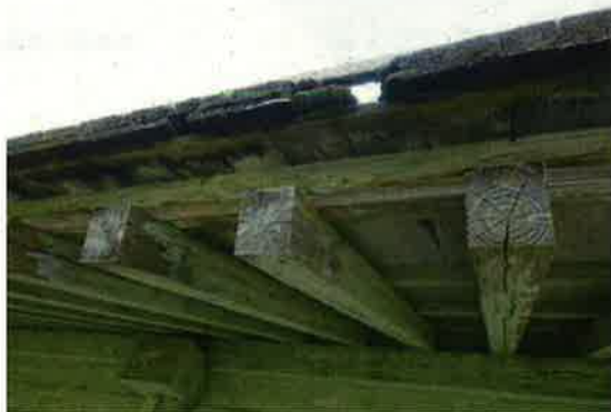
⑦ 東面 _ 軒下の状況 (クレ板・茅負の腐朽)
