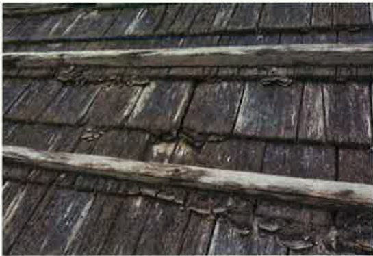
⑤ 東面 _ クレ板の腐朽・苔・茸繁殖
