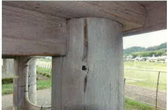
⑥ 節の腐朽
