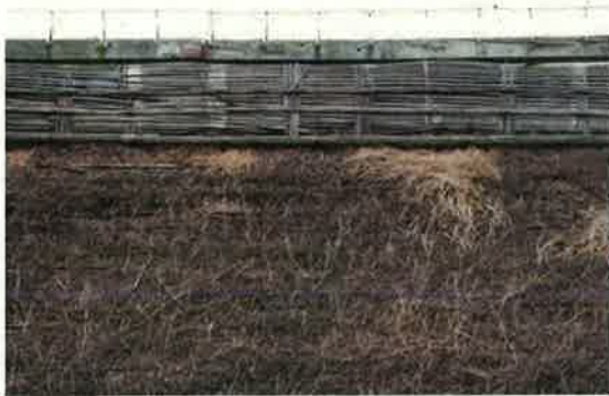
③ 南面中央 棟 ひしぎ竹の欠落、茅の啄み
