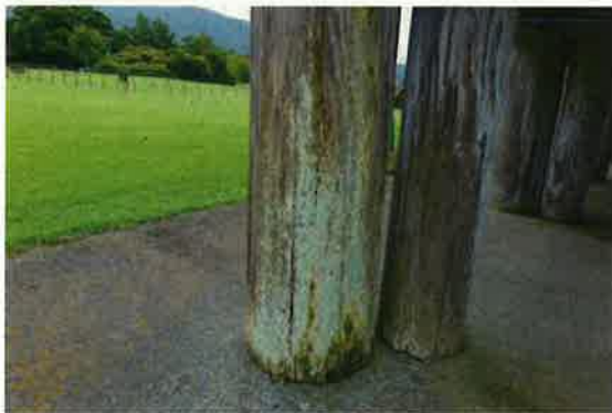
⑦ 北列東の通し柱の苔
