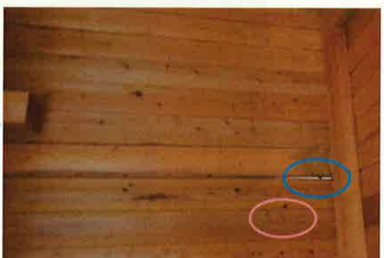
⑧ 東面_雨染み、光漏れ
