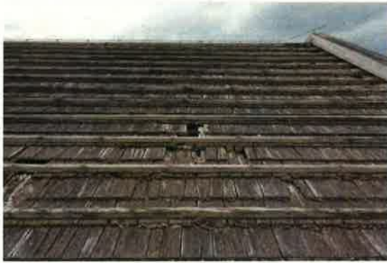
① 東面 _ クレ板、板押えの腐朽状況
