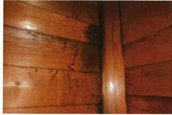
② 北東角_腐朽状況
