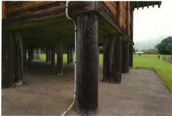
③ 柱の割れ
