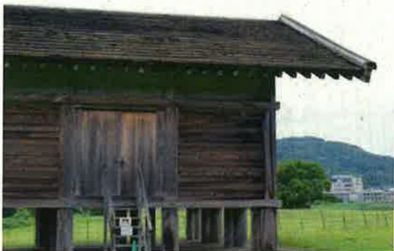
⑬ 東面北_雨後の様子
