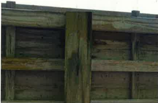
⑪ 北面_母屋と軒裏板の腐朽状況
