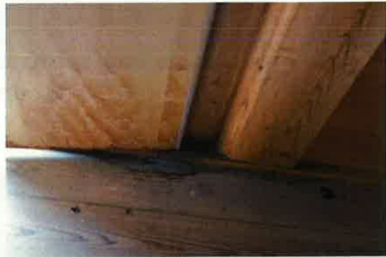
⑥ 南面西扉下部、側壁板、台輪上、床に雨染み
