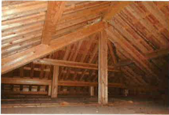
⑨ 小屋組状況、棟端の光漏れ
