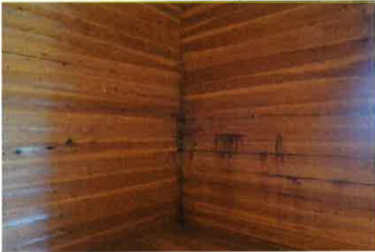
① 南東隅部と南面の雨染み状況
