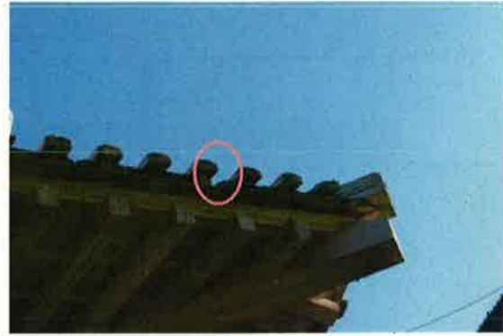
⑩ 北面 屋根葺板の腐朽欠損
