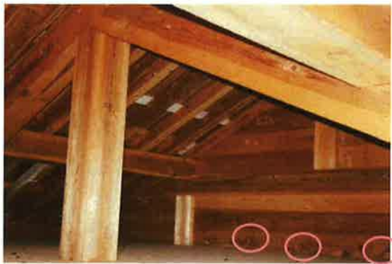
⑰ 板倉北 _ 北妻面, 節より雨染みあり
