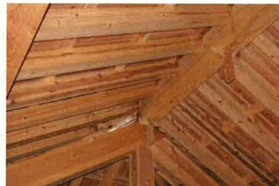
⑫ 棟木の組手納まり、光漏れ、ゴキブリの糞
