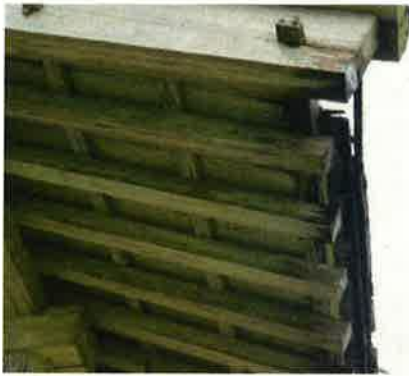
⑨ 西面北_ウダツ・破風板・垂木・クレ板の腐朽
