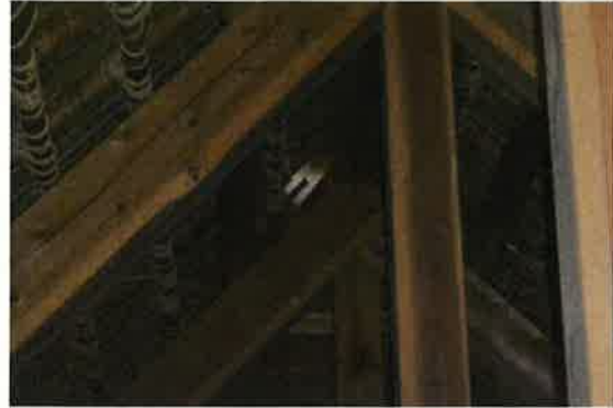
⑱ 棟近くよりの光の漏れ
