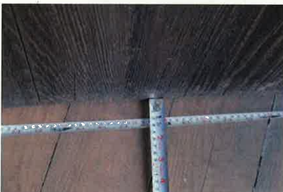
⑦ 東面_扉の反り
