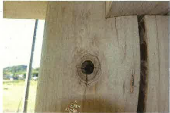
② 束柱割れ、節の腐朽落脱
