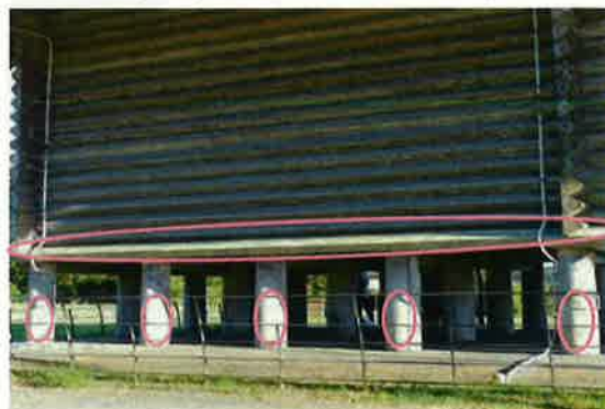
⑮ 北面 台輪および柱脚の緑苔
