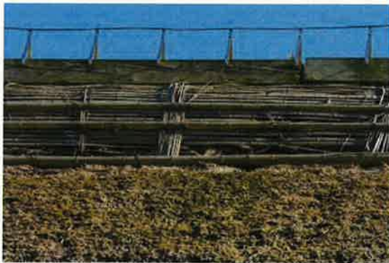
⑪ 北面中央 棟 ひしぎ竹欠損、剣刀木腐朽
