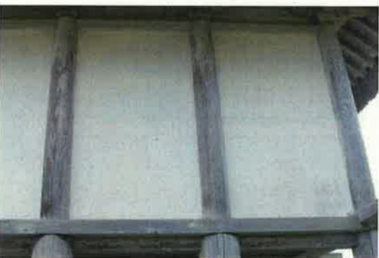
⑮ 東面 漆喰壁に黒カビ
