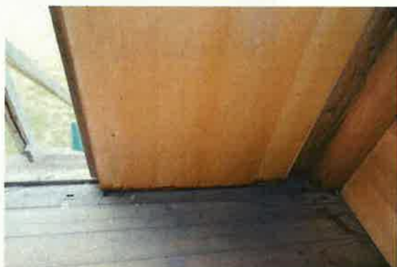
⑥ 東面_扉・側壁板・側柱下部の雨染み
