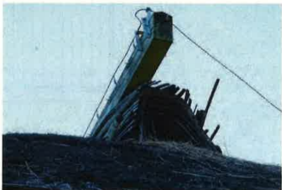
⑯ 東面 剣刀木の腐朽と割れ、キリトビ周りの竹の欠落
