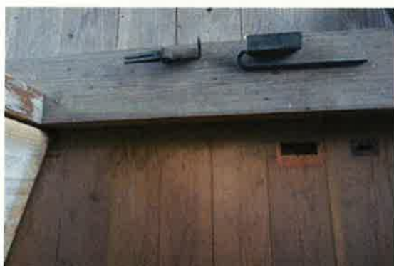
⑤ 東面 出入口床に雨染み
