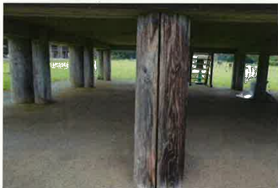
⑤ 柱の割れ
