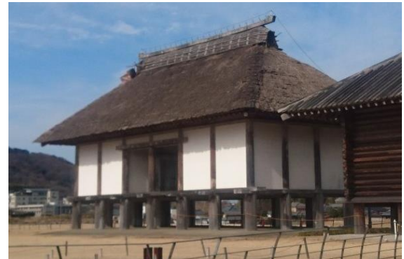
土倉屋根破損状況
