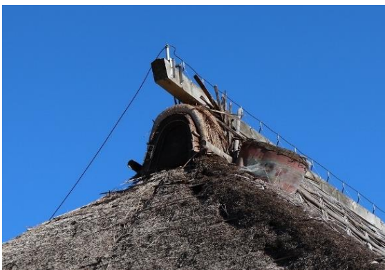
土倉屋根破損状況
