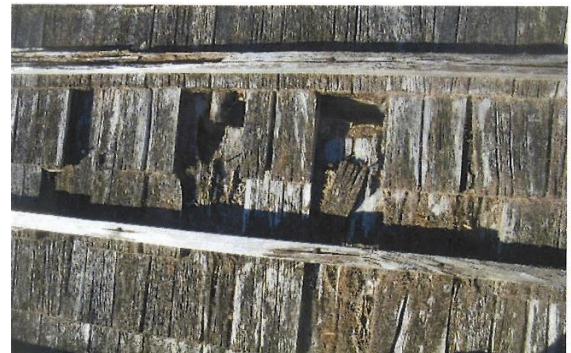
板倉樽板の劣化状況
