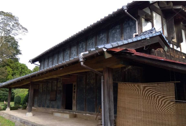
米蔵・北西から 大正10年建築と伝わる。1階庇には継目の無い長大な材が使われている。
