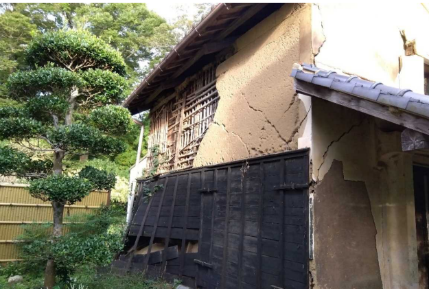
北側蔵・北西から 東日本大震災で壁が大きく崩落し、未補修のまま。現状では立ち入りはできない。
