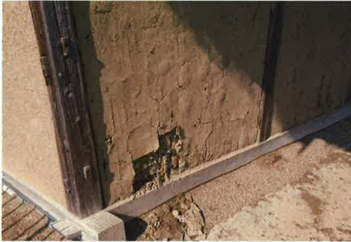
1-(1) 五角堂北壁 土壁崩落状況 (北東から撮影)
