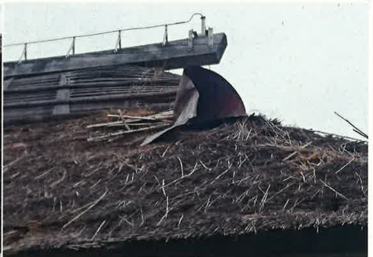
2-(2) 平沢官衙遺跡 土倉屋根破損状況(6月) (南東から撮影)
