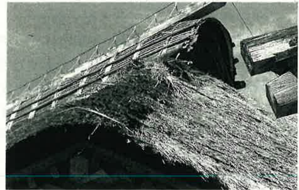
土倉屋根損壊状況
