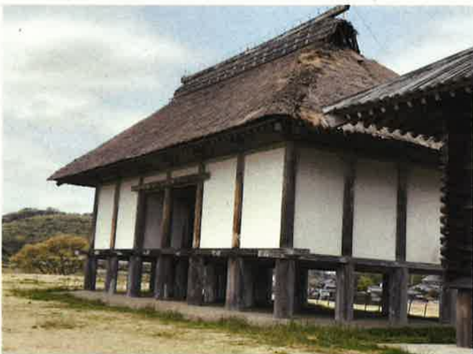
2-(1) 平沢官衙遺跡 土倉屋根破損状況(4月) (南東から撮影)
