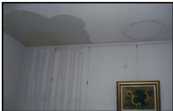
【雨漏りの発生（筑波公民館）】
