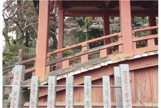
修理前(東から) 合成塗料による塗装が剥がれている。
