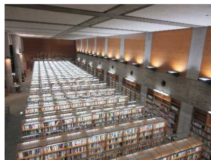
館内照明のLED化
