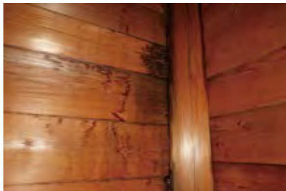
② 北東角 腐朽状況
