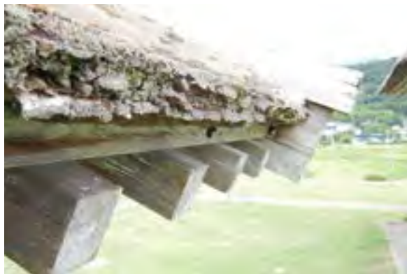
⑧ 東面 軒先（樽板木口の腐朽・苔・茸繁殖）
