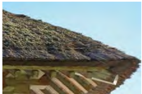
⑫ 北面西 茅欠損とオシボコ露出・茅全体に苔
