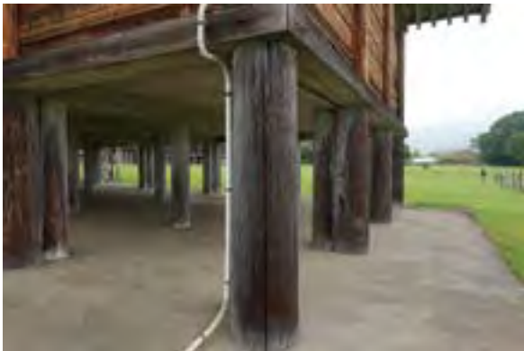
③ 柱の割れ
