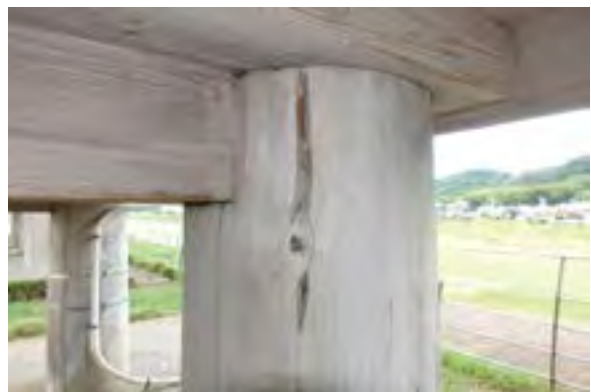
⑥ 節の腐朽
