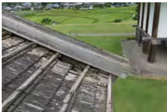
④ 東面北端部 樽板の腐朽・欠損
