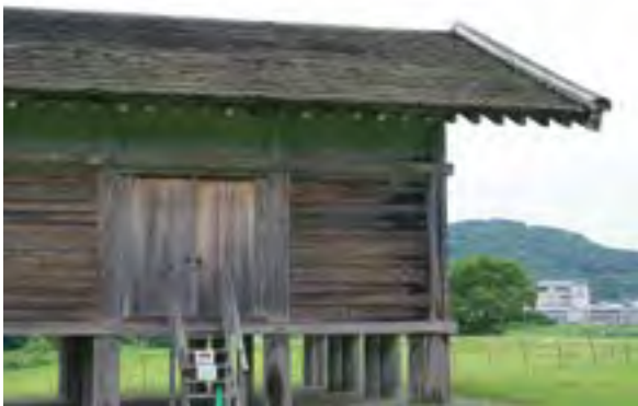
⑬ 東面北 雨後の様子
