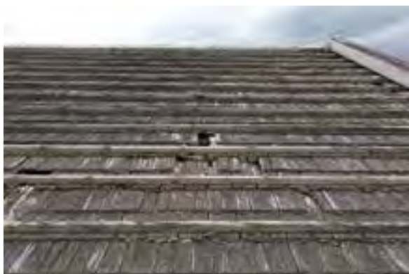
① 東面 樽板、板押えの腐朽状況
