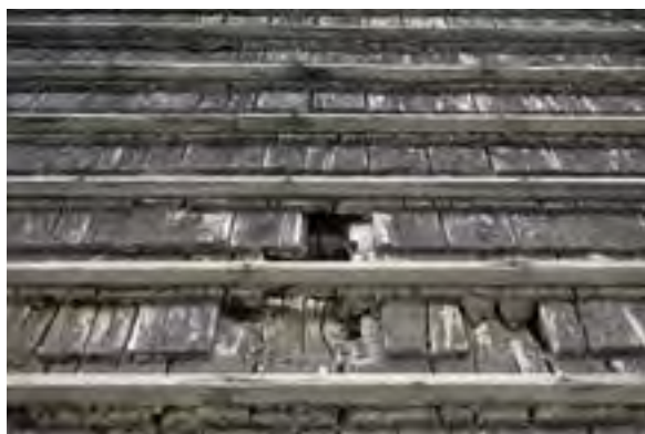
② 東面 樽板、板押えの腐朽・欠損
