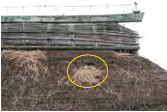
② 南面東 棟 ひしぎ竹の欠落、茅の啄み
