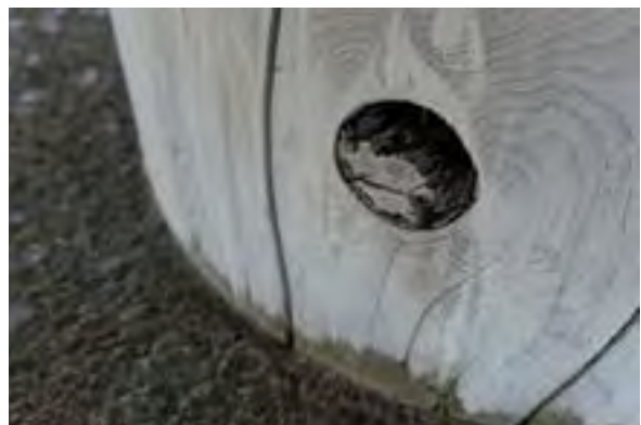
④ 節の腐朽落脱
