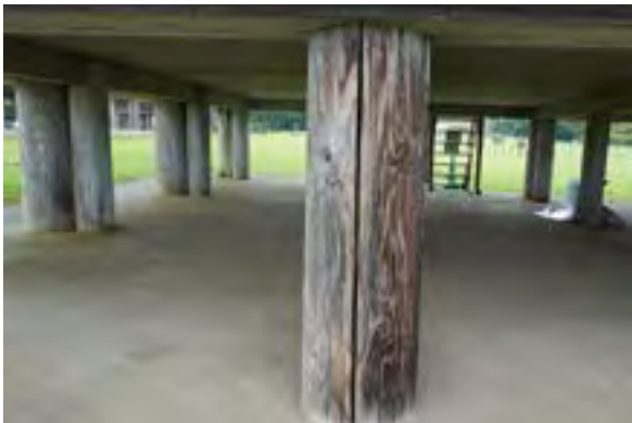
⑤ 柱の割れ
