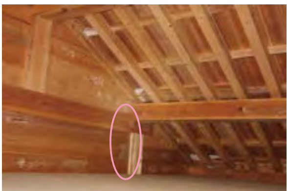
㉓ 板倉南 南妻面，雨染みあり
