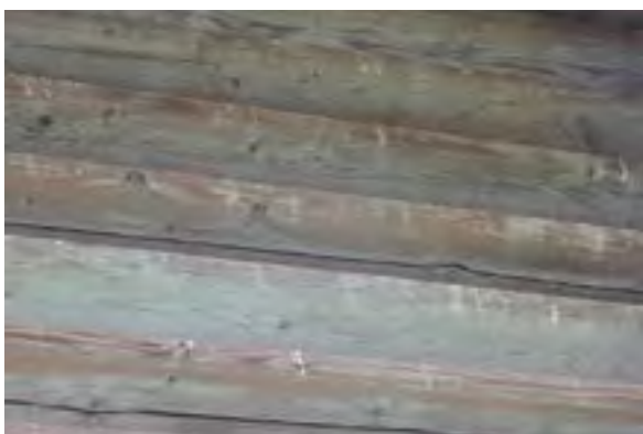
⑬ 西面 鳥の糞による白い液垂れ、校木割れ
