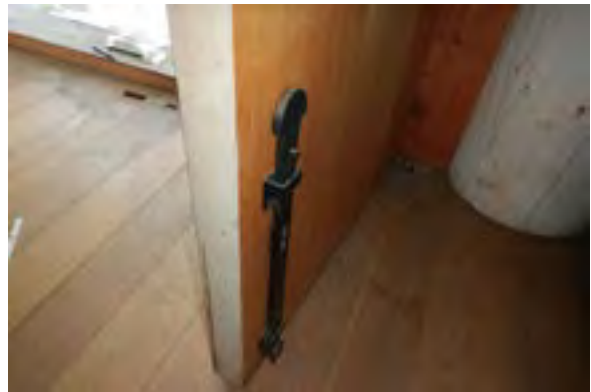
⑥ 東面 出入口床に雨染み、扉の亀裂
