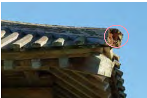
⑨ 北面 隅樋棟の木口の腐朽欠損
