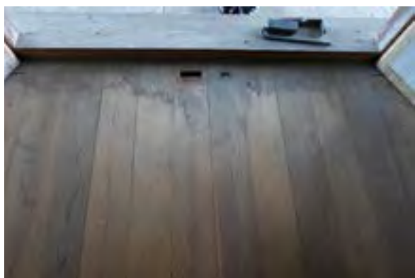
⑬ 東面 出入口床に雨染み
