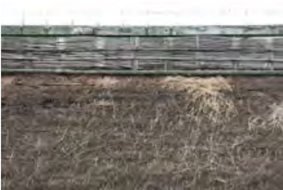
③ 南面中央 棟 ひしぎ竹の欠落、茅の啄み
