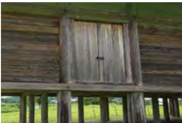
⑮ 扉の湾曲、金具の浮き
