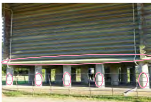
⑮ 北面 台輪および柱脚の緑苔
