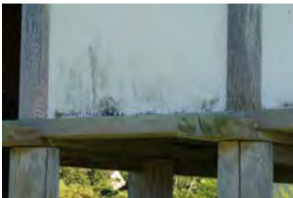
⑬ 北面東 漆喰壁に黒カビ汚れ
