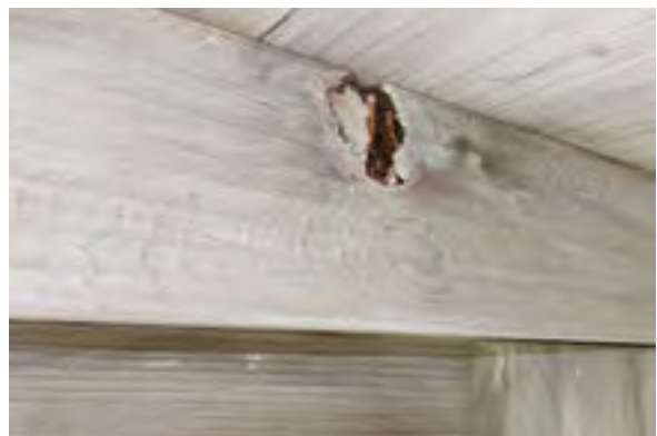
④ 節の腐朽落脱
