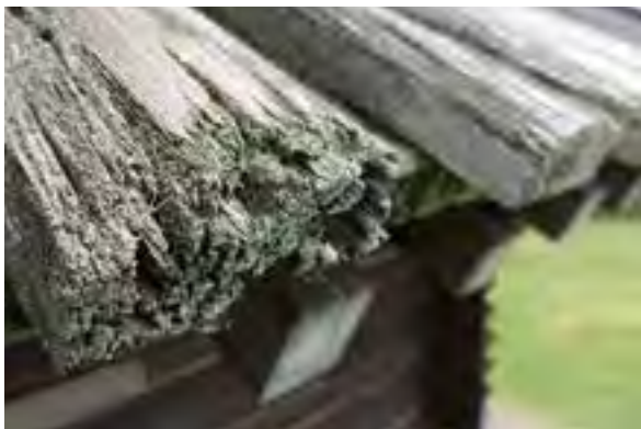
⑤ 南面 目板と葺板の木口の腐蝕と苔
