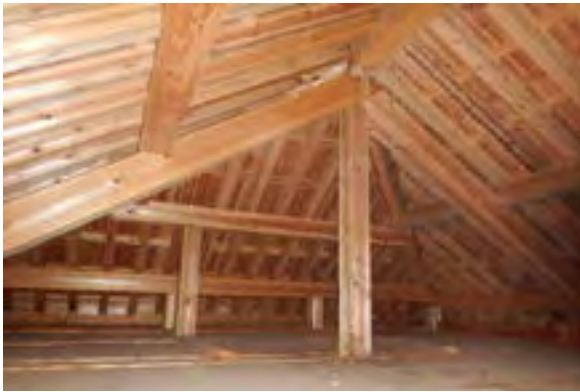
⑨ 小屋組状況、棟端の光漏れ
