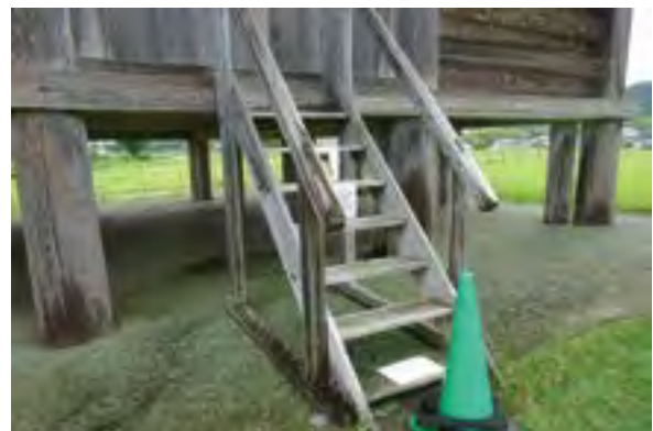
⑯ 階段の腐朽、タタキの苔
