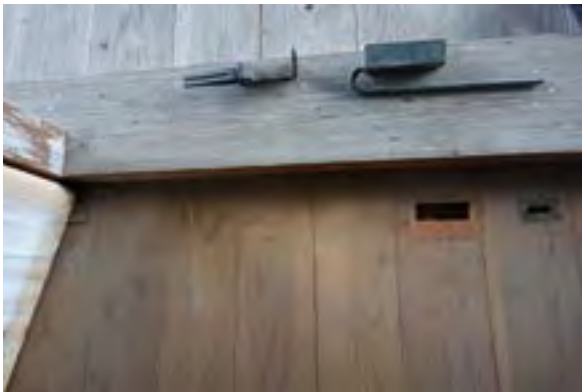
⑤ 東面 出入口床に雨染み
