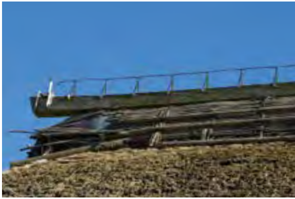
⑨ 北面東 棟 竹類の欠損と折れ、竹簧破損
