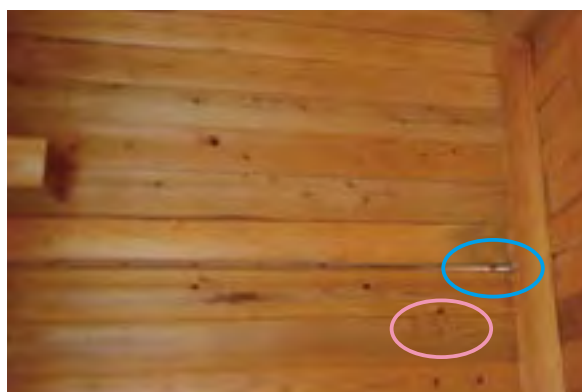
⑧ 東面 雨染み、光漏れ
