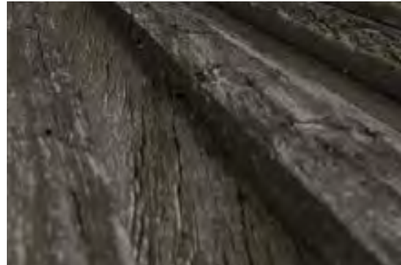
④ 南面 目板と葺板の腐朽
