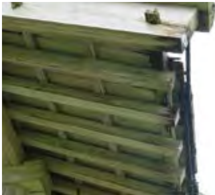
⑨ 西面北 宇立・破風板・垂木・樽板の腐朽
