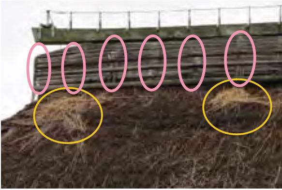
① 南面西 棟 ひしぎ竹の欠落、茅の啄み
