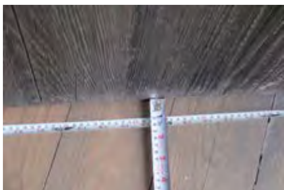
⑦ 東面 扉の反り
