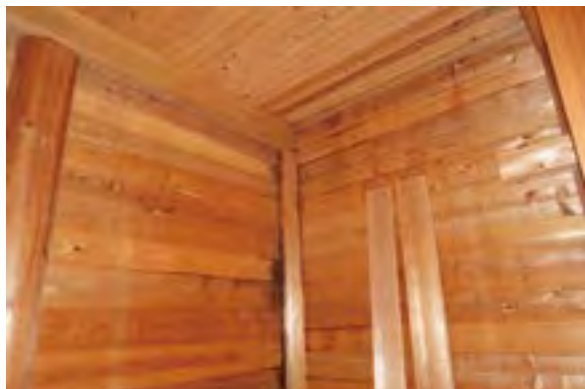
① 北東角 腐朽状況
