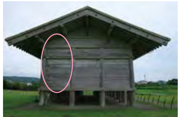
⑫ 北面 雨後の様子（薄い変色）、柱脚の苔
