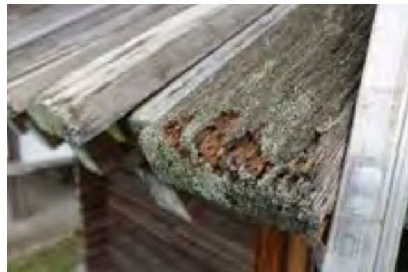
⑥ 南面 目板と葺板の木口の腐蝕と苔
