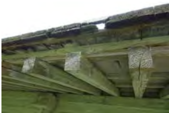
⑦ 東面 軒下の状況（樽板・茅負の腐朽）
