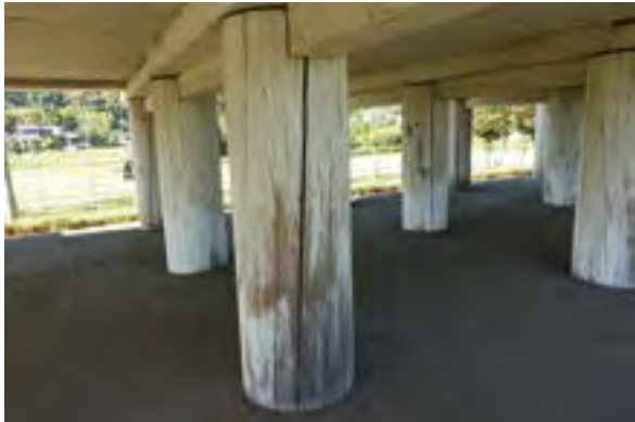
① 束柱割れ
