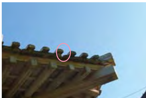
⑩ 北面 屋根葺板の腐朽欠損
