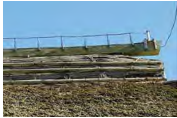
⑩ 北面西 棟 ひしぎ竹欠落
