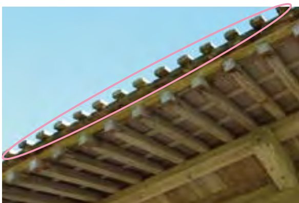
⑪ 北面 屋根目板と葺板の木口の腐蝕と苔繁殖
