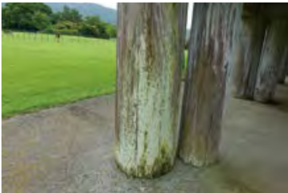
⑦ 北列東の通し柱の苔
