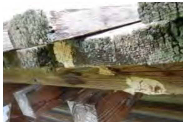
⑧ 南面 目板と葺板の木口付近の地衣・苔
