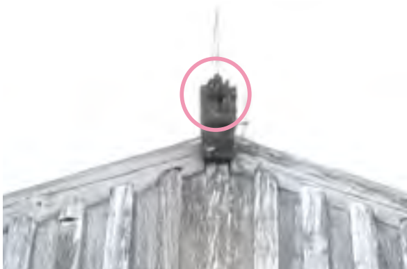
③ 東面 樋棟木口の腐朽
