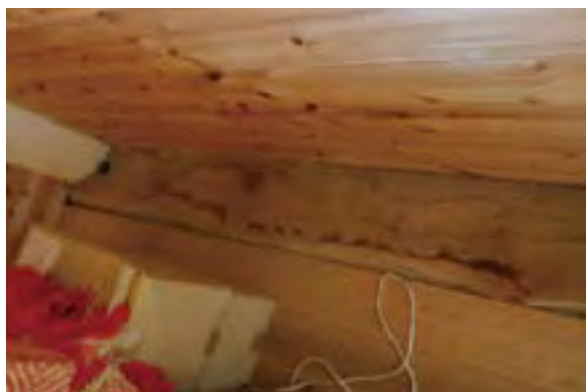
⑨ 南面 台輪上に雨染み
