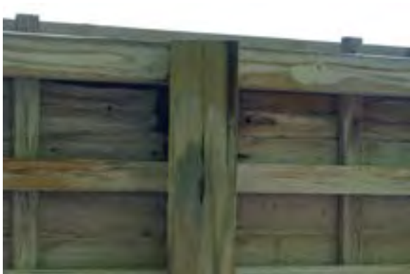
⑪ 北面 母屋と軒裏板の腐朽状況
