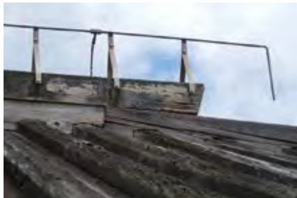
② 左に同じ木材の腐朽、避雷針の上下逆向き
