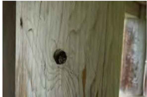
② 節の腐朽
