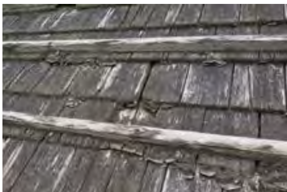
⑤ 東面 樽板の腐朽・苔・茸繁殖
