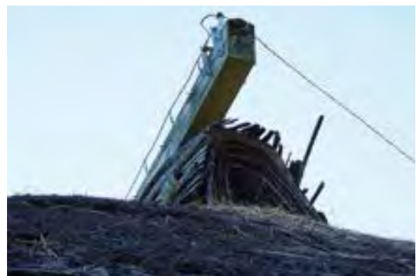
⑯ 東面 剣刀木の腐朽と割れ、キリトビ周りの竹の欠落
