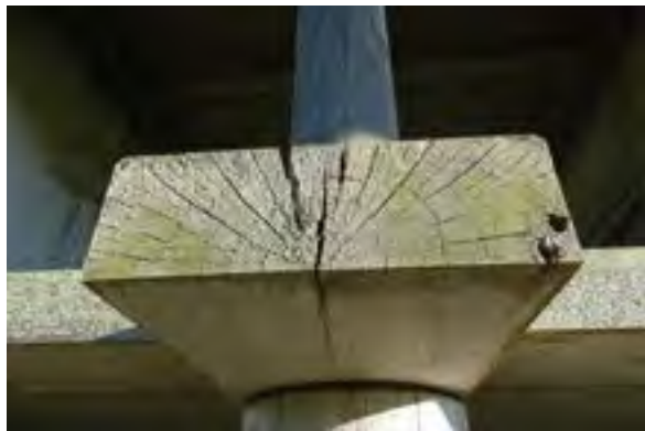
⑦ 北面_台輪の割れ、苔、虫害
