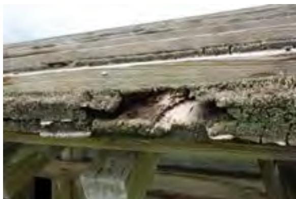
⑥ 東面 軒先（樽板木口の腐朽・苔・茸繁殖）
