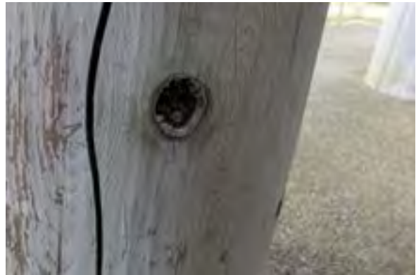
② 節の腐朽落脱
