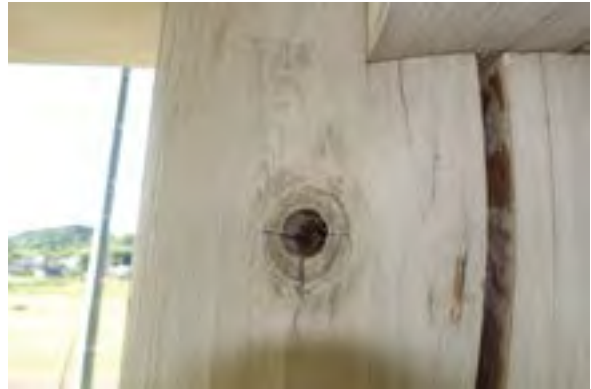
② 束柱割れ、節の腐朽落脱
