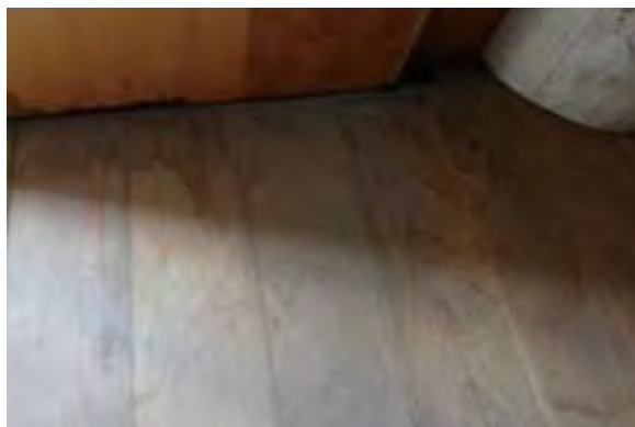
⑯ 東面 床の雨染み
