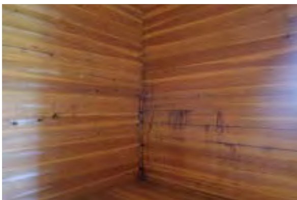
① 南東隅部と南面の雨染み状況
