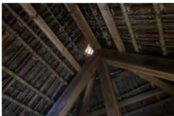
⑲ 棟端部の光の漏れ
