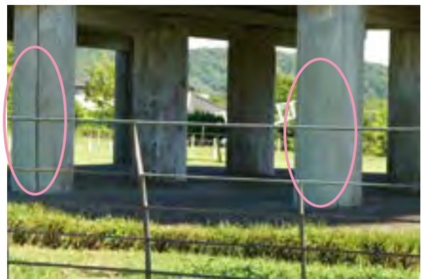
⑭ 北面 柱脚北側に苔
