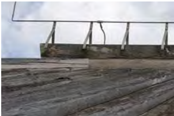
① 南面 樋棟・樋棟台・隅樋棟・樋棟台・目板・葺板の腐朽
