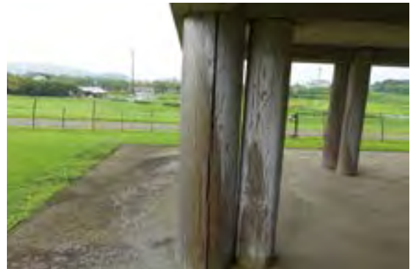
④ 柱の割れ
