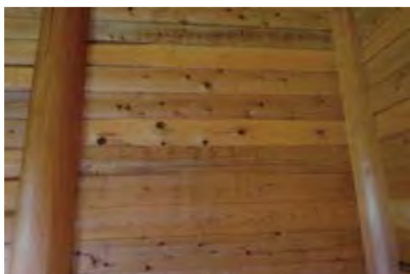
⑪ 南面 雨染み状況
