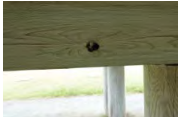
⑥ 大引 節の腐朽
