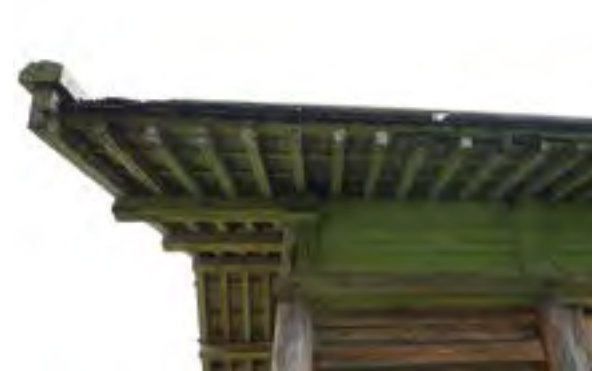
⑭ 東面南 宇立の腐朽、樽板の腐朽と欠損
