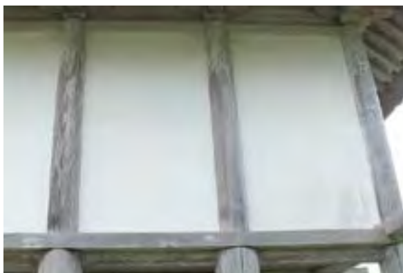
⑮ 東面 漆喰壁に黒カビ
