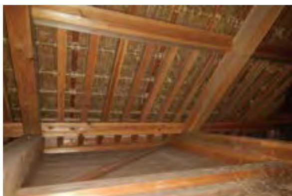
㉓ 小屋組の納まりとボルト使用状況 鳥の糞あり
