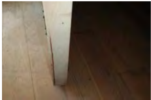
⑧ 東面 扉の亀裂
