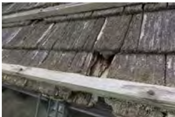
③ 東面 樽板の腐朽・欠損・苔繁殖
