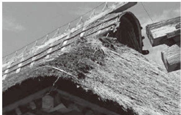
土倉屋根損壊状況
