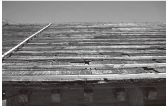
板倉屋根損壊状況
