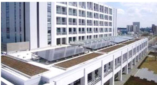
公共施設の太陽光発電設備
