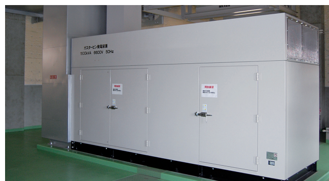
自家発電設備
