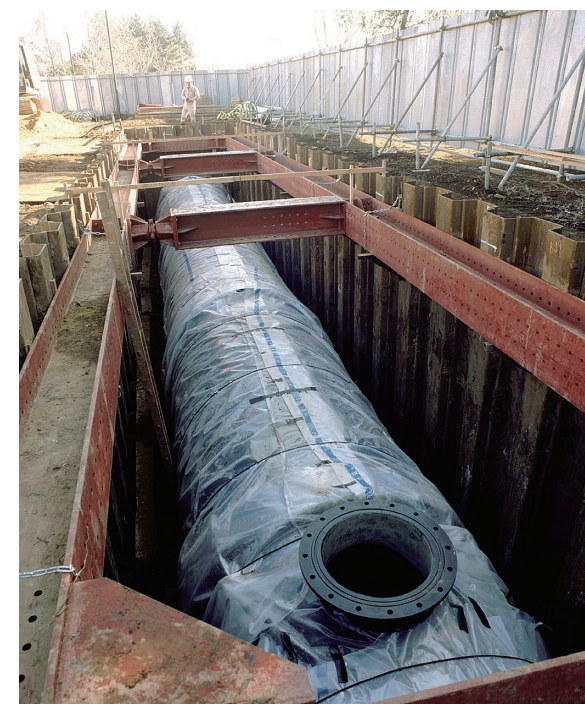
非常用貯水槽（天久保公園内）
