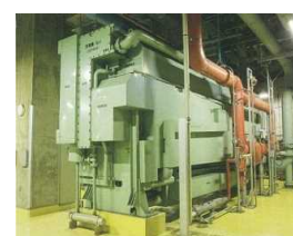
蒸気吸収冷凍機
