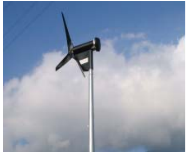
風力発電機 ( 6 kW )
