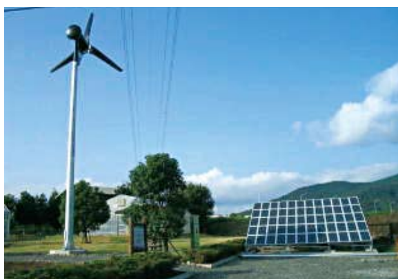
ハイブリット発電システム
