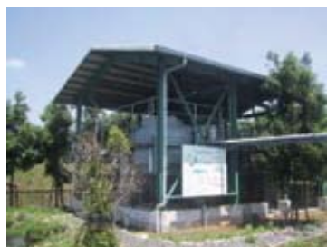
電気化学的処理装置
