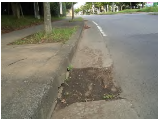
陥没(研究学園地区)
