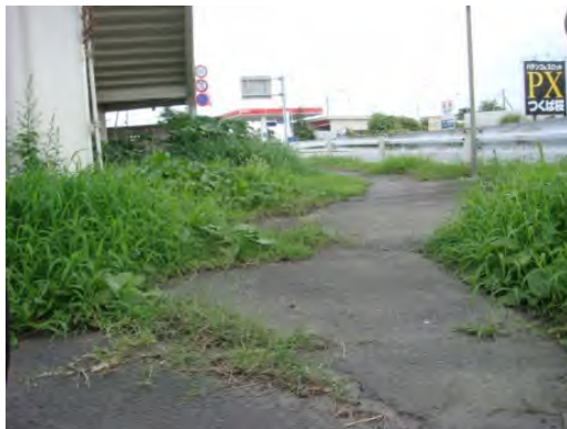
舗装劣化(筑波地区)
