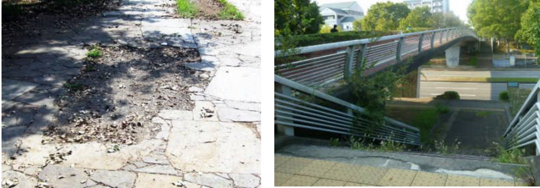
老朽化したペDESTリアンデッキ
