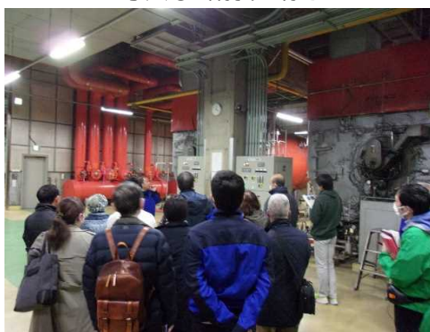
写真③ 地域冷暖房施設1
