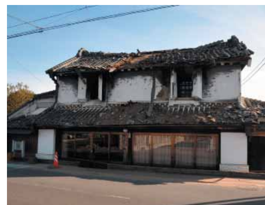
大きな被害を受けた国登録有形文化財の宮本家住宅(北条)
