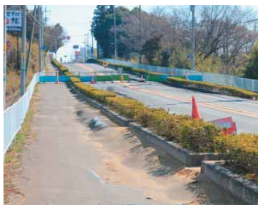
通行止めとなっている国道354号線谷田川橋付近
