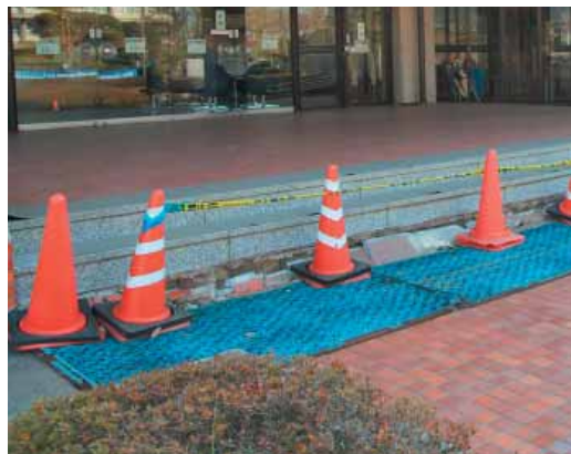
地盤沈下で段差が生じた市民ホールやたべ
