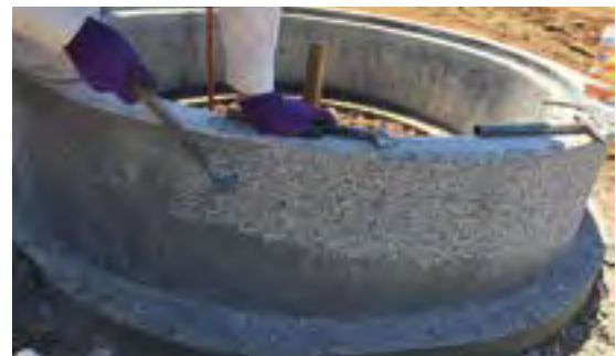
コンクリートビシャン仕上げ参考例 (例はツツキ仕上げ)
