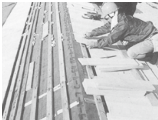
当初整備 樽板下のアスファルトルーフィング 「整備事業報告書」より
